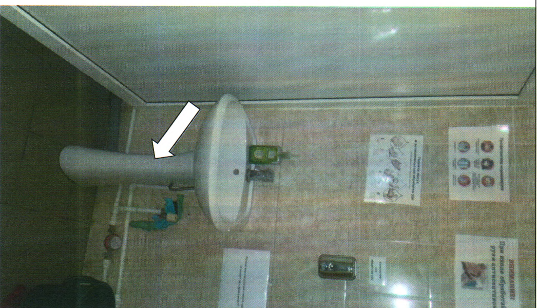
Фото № 12. Нет опорных поручней для умывальника. Умывальник расположен на пьедестале.
