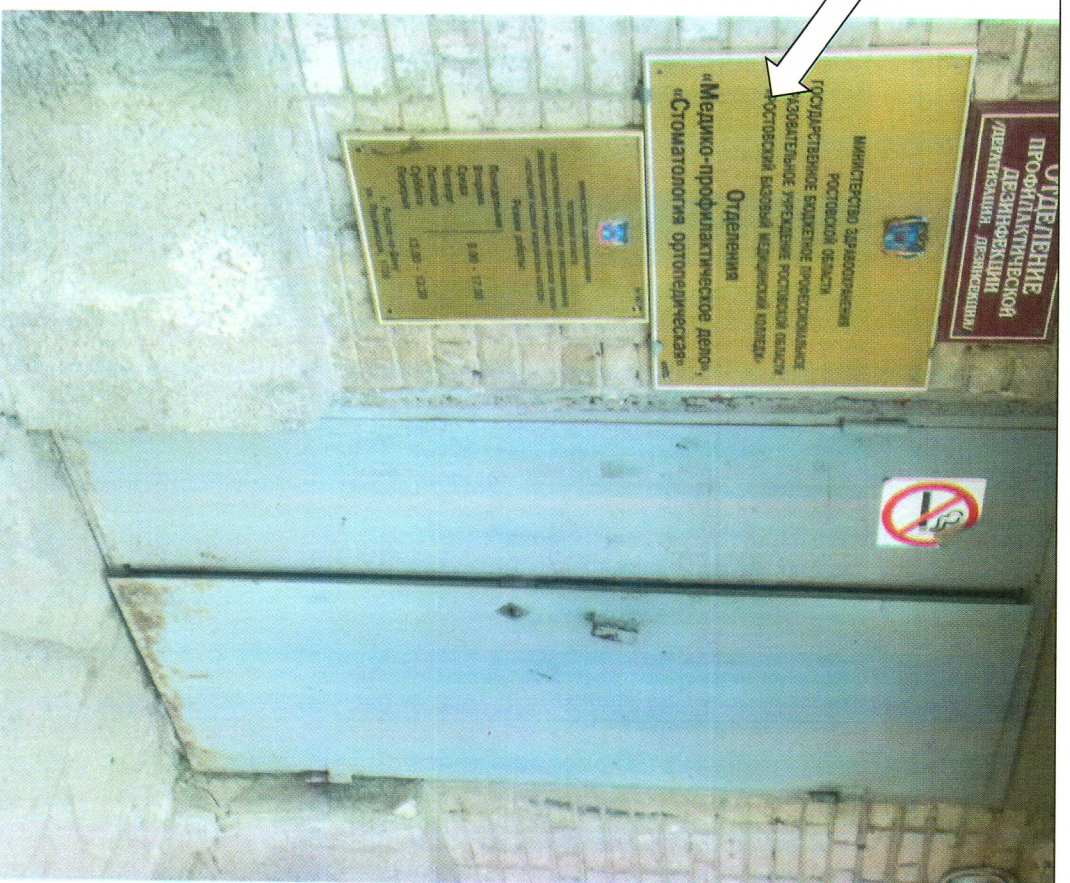
Фото № 2. Вход в отделение «Медико-профилактическое дело», «Стоматология ортопедическая». Установлена не тактильная табличка об объекте
