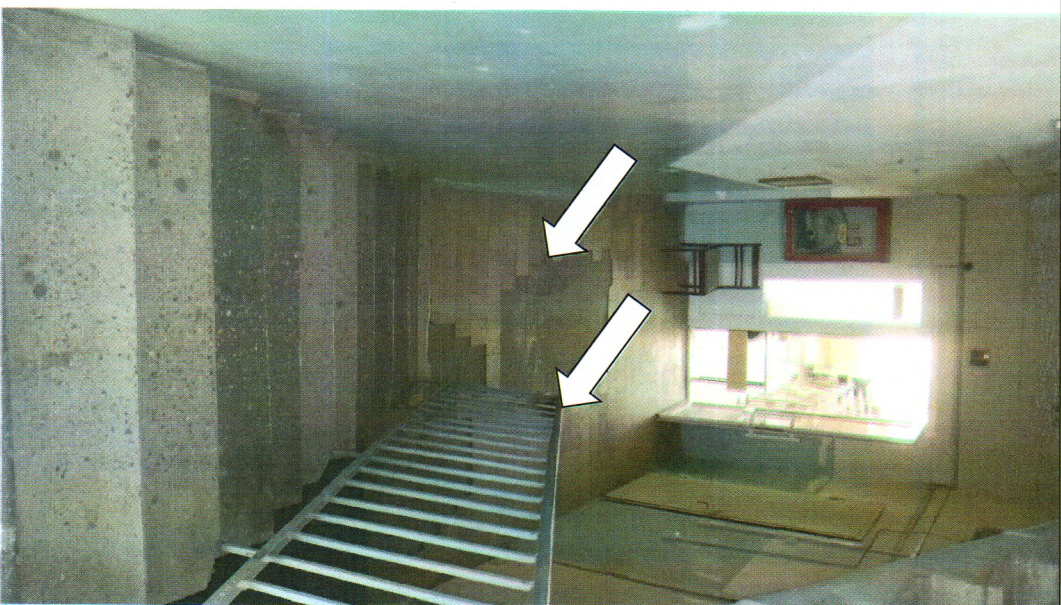
Фото № 7. Нарушена целостность покрытия. Установлен поручень с одной стороны лестницы
